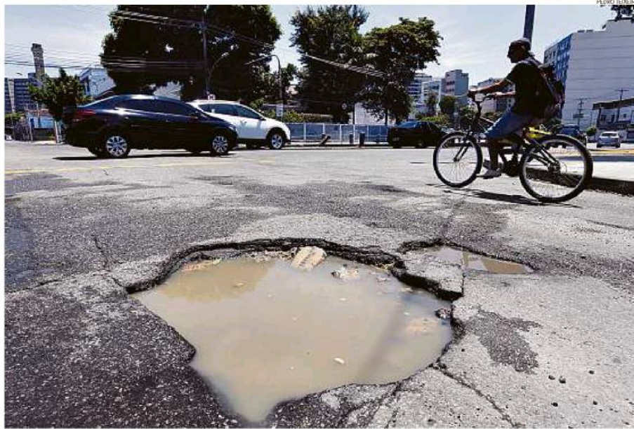
Obstáculo. O buraco na Rua Felipe Camarão, no Maracanã, que há um mês obriga motoristas a desviarem: até plantas foram usadas como sinalização
